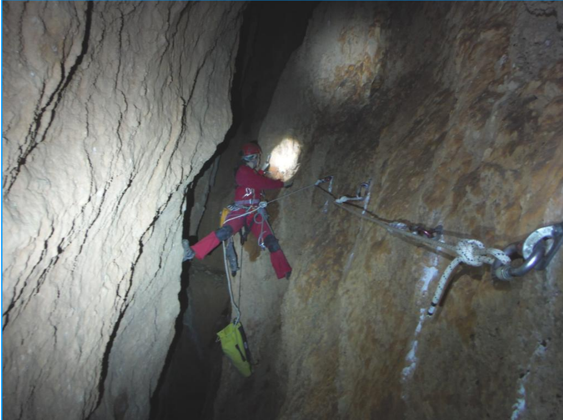
Instal·lació d'un passamans en la O-7, per tal d'accedir a una incògnita.
